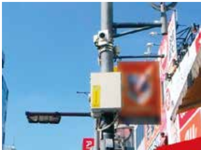
街頭防犯カメラの設置状況
