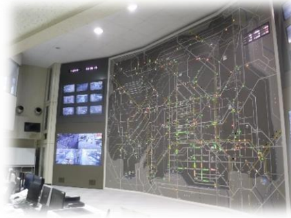
交通管制センター
