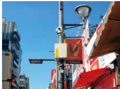
街頭防犯カメラの設置状況
