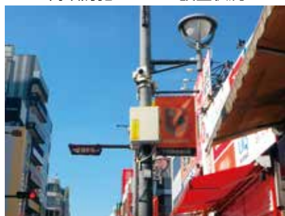
街頭防犯カメラの設置状況
