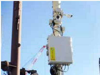
街頭防犯カメラの設置状況
