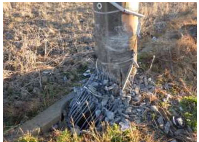
電柱の破損状況
